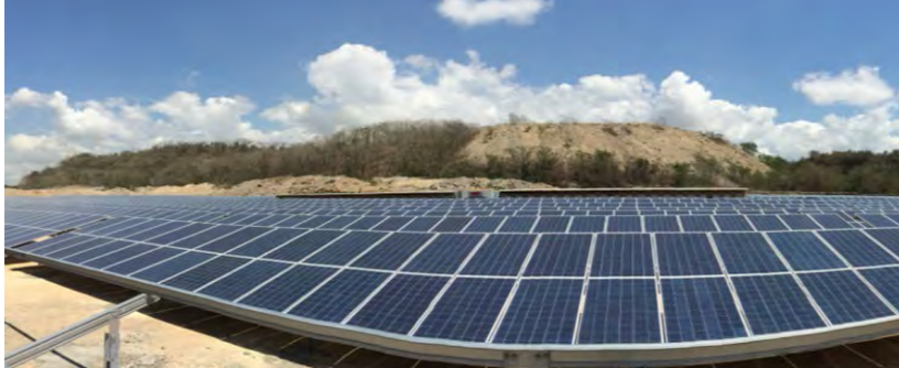
Instalaciones de energía solar. Planta de cemento San Pedro de Macorís, República Dominicana
