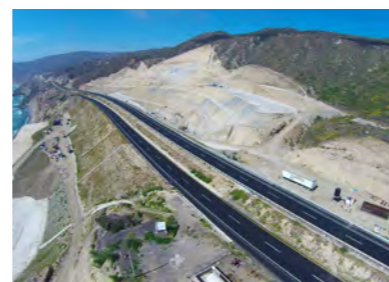
Infraestructura. Restitución del Terraplén de la Carretera Tijuana-Ensenada al KM 93 Ensenada, México
